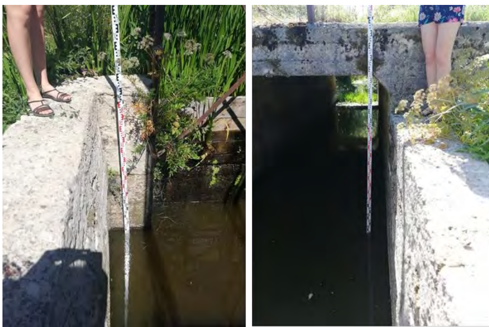
55. attēls. Nelikumīgi pārbūvētā pārgāzne, pa kreisi, atvērta caurtekas/regulatora daļa, pa labi.
