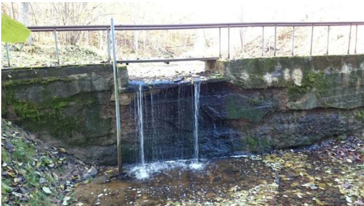
3.foto. Betona aizsprosta un teknes lejasbjefa sienas bojājumi, skats no lejasbjefa
