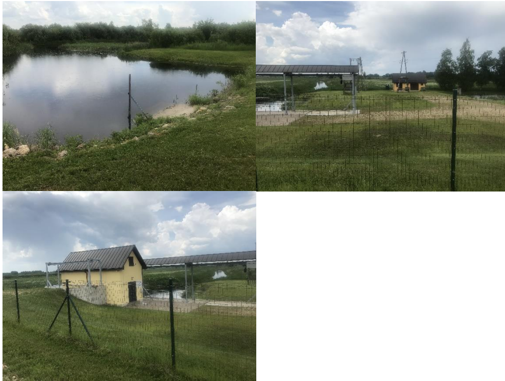
66. attēls. Zvidzienes poldera sūkņu stacija (56.82588°, 26.86972°)
