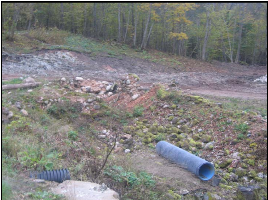
3.16. att. Zivju dīķa ierīkošana Nurmīžu dabas lieguma teritorijā. Šajā gadījumā nav pievērsta uzmanība ainavas estētiskās kvalitātes saglabāšanai. Rodas priekšstats, ka dīķa izbūve te notikusi bez plāna un projekta.
