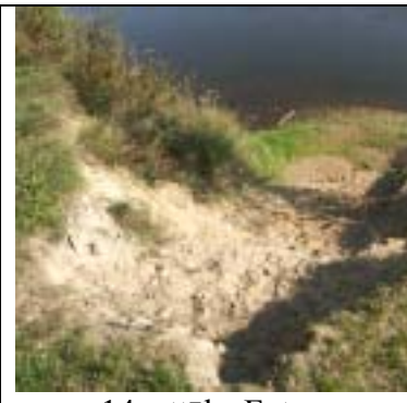
14. attēls. Foto: J.Smaļinskis Ūdenstūristu izkāpšanas vieta un erozijas grava tūristu apmetnē Lenčupe
