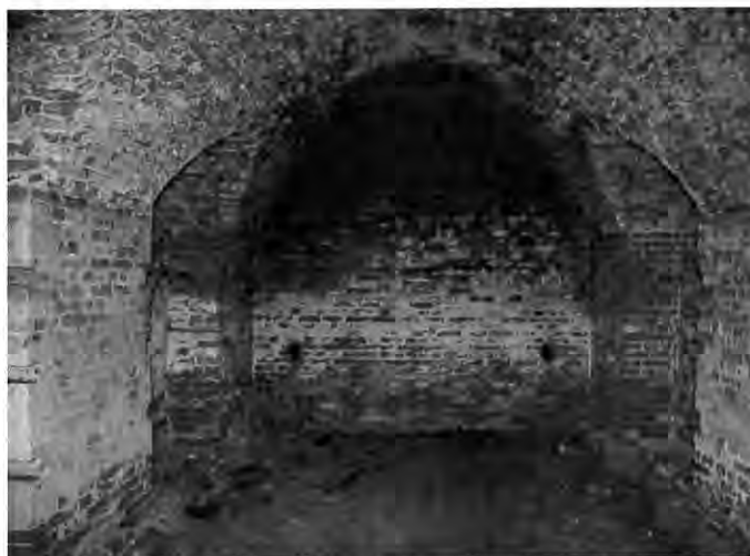
2.attēls Apkvēpušas sienas un griesti divos dažādos Mangaļsalas fortos (I.Priednieces foto).
