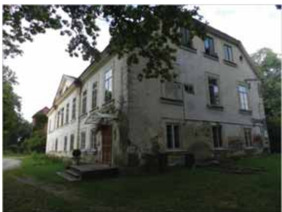
7.9. attēls. Ziemeru muižas pils ar stilam un laikam neatbilstošiem elementiem un neremontētām fasādēm
