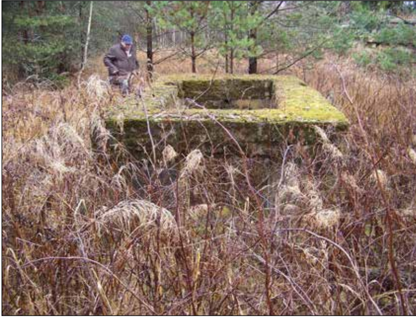
Dzelzsbetona nocietinājumu sistēma pie ceļa Kščeva – Birulišķi. Betona kubs, skats no R. Foto: I. Virse.
