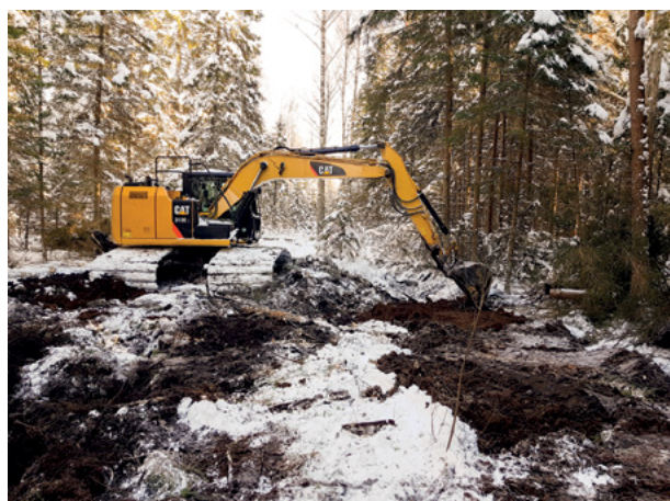
7. attēls. Savācējgrāvju aizbēršanai un ūdensnovades barjeru izveidošanai lietotais ekskavators Zaļajā purvā. Foto: A. Pilābers.
