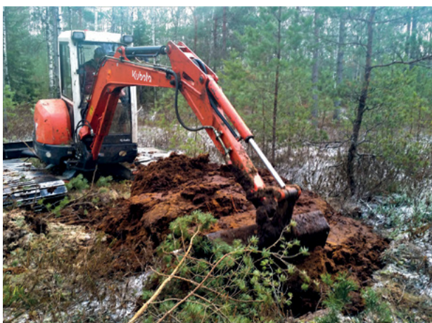
5. attēls. Kūdras aizsprosta būvniecība uz neliela grāvja Zaļajā purvā, izmantojot ekskavatoru. Foto: E. Jumītis.
